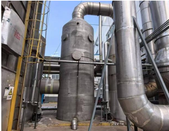
水洗+碱喷淋(逆流雾化喷淋塔)
