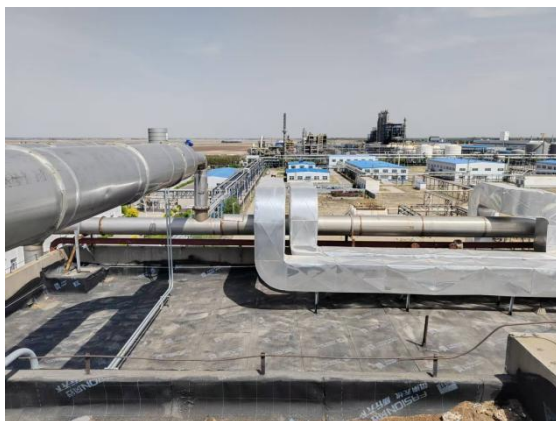
应急切换管道通入原提取二期尾气系统
