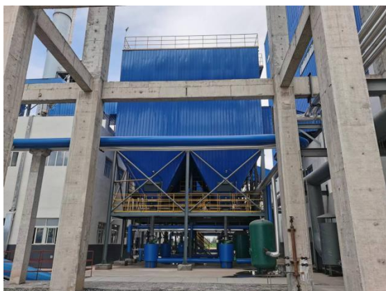
锅炉布袋除尘器
