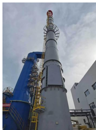
锅炉排气筒（DA015）
