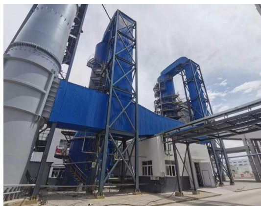
锅炉脱硫脱硝
